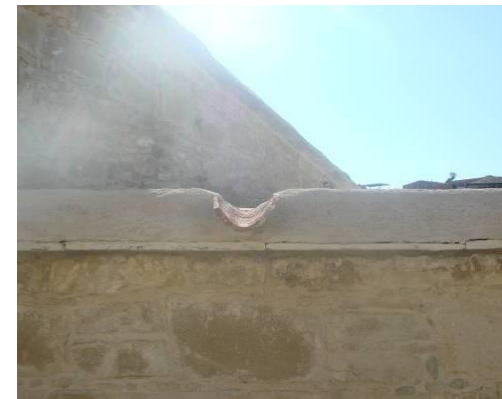
Λεπτομέρεια κροδώματος κατοικίας με χολέτρα από κεραμίδι για το νερό της βροχής (αλλοίωση κατά την αποκατάσταση).
