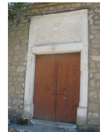
Θύρα εισόδου. Περιμετρικά διακρίνεται το πλαίσιο από πελεκητή πέτρα το οποίο αλλοιώθηκε.
