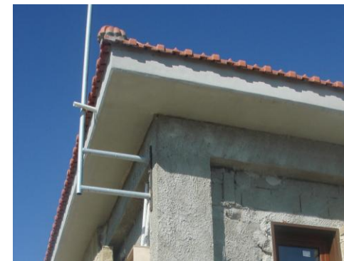
Λεπτομέρεια προεξοχής της στέγης. Μεγαλύτερη απόσταση από την παρειά της τοιχοποιίας (50-60 εκ.).
